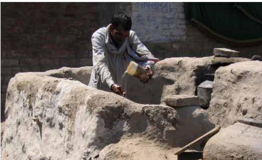
ARRIBA E IZQUIERDA Una comunidad local innovó este método de absorber las aguas grises desechadas de un baño en una olla de barro perforada, llena de piedras pequeñas y enterrada en una aldea en el estado de Maharashtra en la India. Esto mantiene limpio y seco el camino, el cual antes siempre estaba con barro y sucio.
