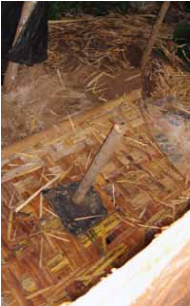
Izquierda Una letrina de pozo ciego construida inmediatamente después de la activación en la comunidad de Uletana Bakole cerca de Arbaminchen Etiopía. Note el bambú, esteras y plásticos, todos los cuales están disponibles localmente. Muchas veces las letrinas se van mejorando con el tiempo.
