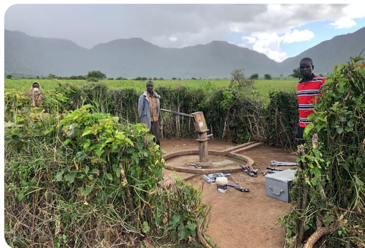
Point d'eau près de Karenga en cours de maintenance.
